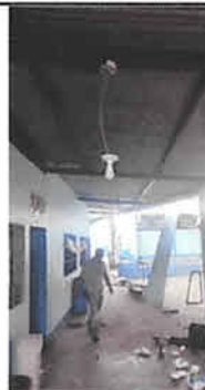
Foto 2: Instalación eléctrica en mal estado.
